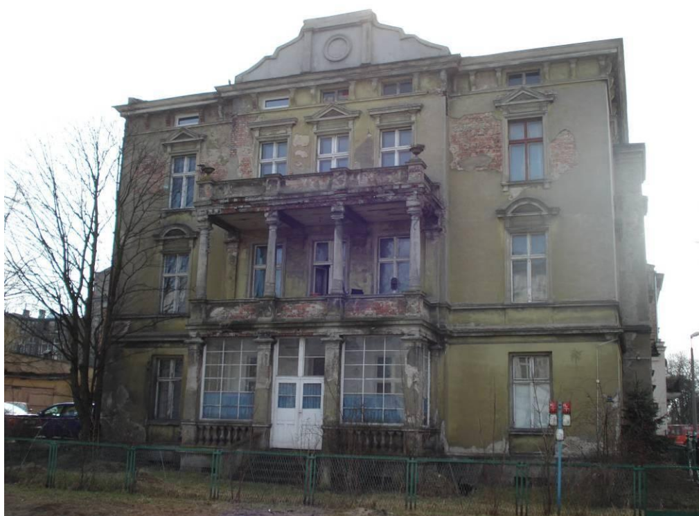
... i przy ul. Krasieńskiego – oba obiekty niezwykle cenne m.in. ze względu na wiek i architekturę – oba niestety w tragicznym stanie technicznym
